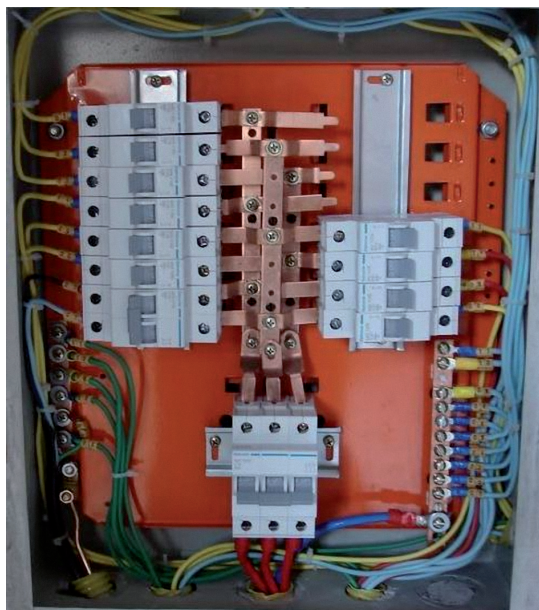
Figura 4.16: Foto de um quadro de distribuição real
